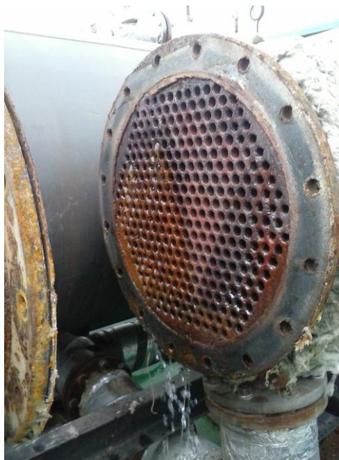
Рисунок 4.3 – Кожухотрубний теплообмінник з корозією трубок
