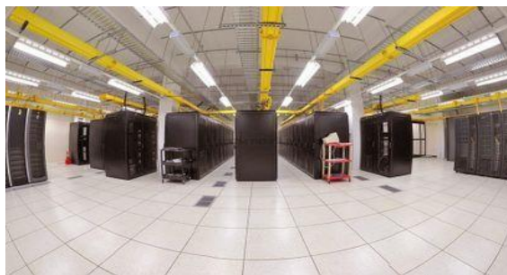
Рисунок 8 – Серверна кімната із встановленими в ній пристроями для стеження за температурою
