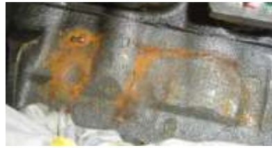
Рисунок 3.43 – Тріщина після гідрравлічних випробувань
